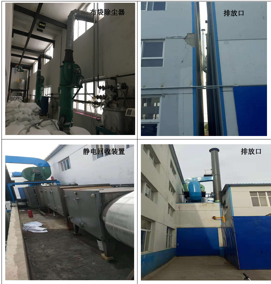
图 4-2 布袋除尘器、静电回收装置及排放口现场照片
